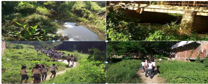
Figura 5 - Visita técnica a ponte que faz divisa entre o município Itororó- Ba e o Distrito de Bandeira do Colônia, Itapetinga – Ba.
