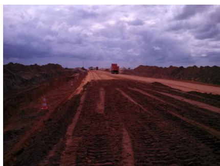
Figura 6 - Acesso a subestação do Parque Eólico FONTE: Elaborado pelos autores (2014)
