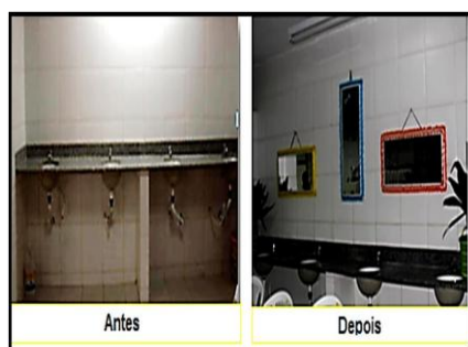
Figura 07 – Lavabo - Antes e depois de intervenções.
